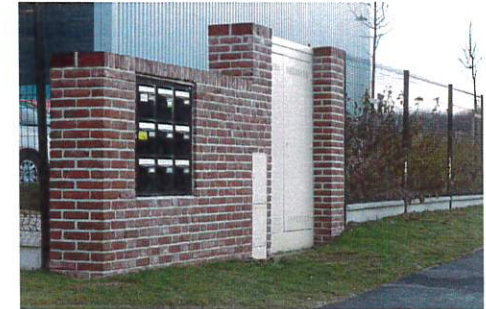
Boîtes aux lettres et coffrets électriques
