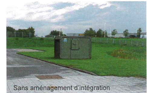
Poste de transformation
